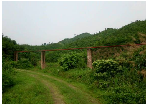
水冶厂部分污染管道现状
