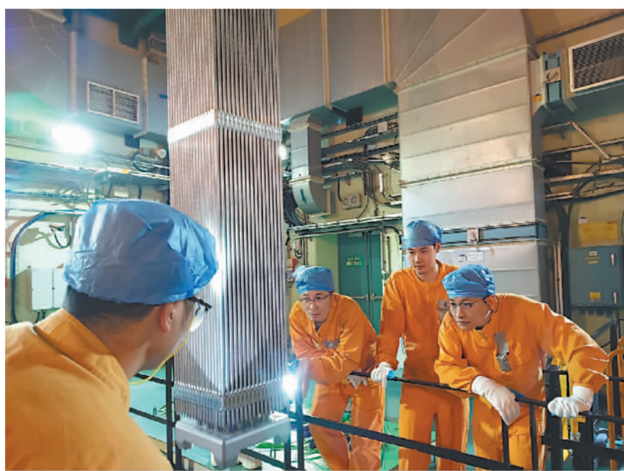
华东核与辐射安全监管站近日对核核电运行管理方有限公司方家山核电厂新燃料组件的入场接收工作进行全面、细致的现场监督。图为监督员进行方家山核电厂1号机组新燃料组件入池前外观检查。 茆龙摄
