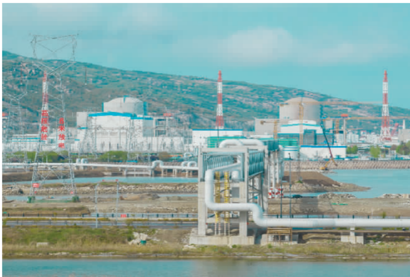
图为“和气一号”项目蒸汽供能管道。
