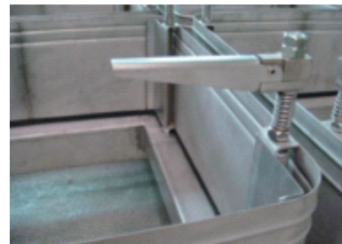
图 7 过滤器排架实物图
