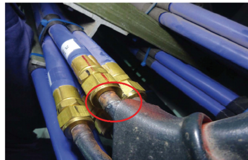
图4 变频器冷却系统铜管漏点
