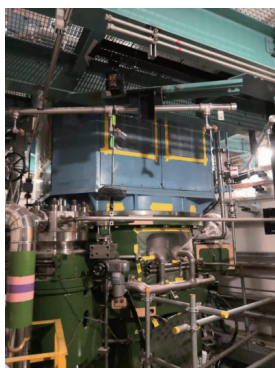
图6 主泵隔间现场图(一)
