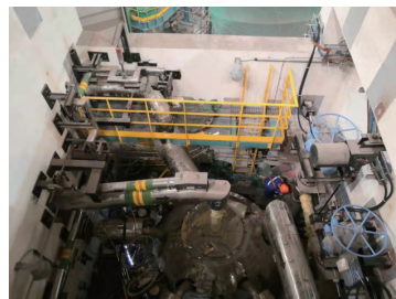
图5 稳压器隔间现场图(二)
