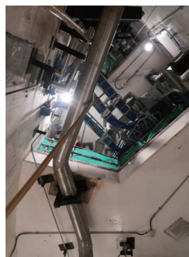
图9 卸压箱隔间现场图(二)
