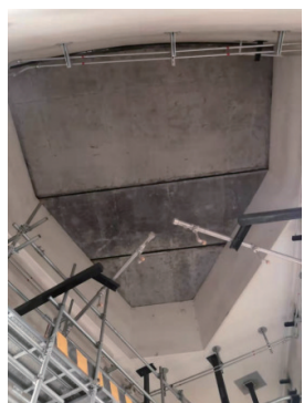
图7 主泵隔间现场图(二)
