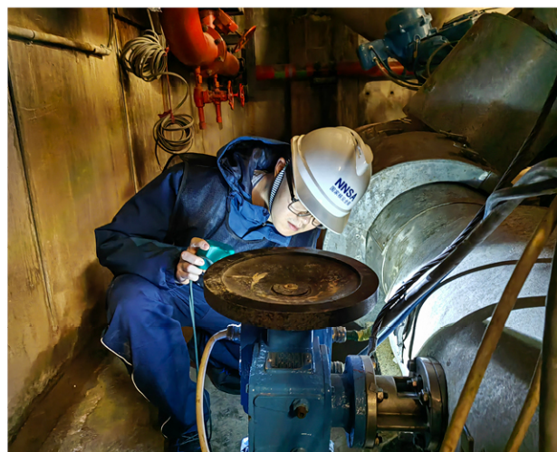
图 11 红沿河核电厂重要厂用水系统监督检查
