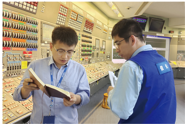
图6 秦山第三核电厂主控室监督检查
